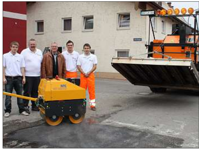
Die Firma Instratec zeigte ihre neu entwickelte Art der ökologischen Straßenreparatur, wofür sich Bürgermeister Max Schadenfroh besonders interessierte. – Fotos: Jahrstorfer
